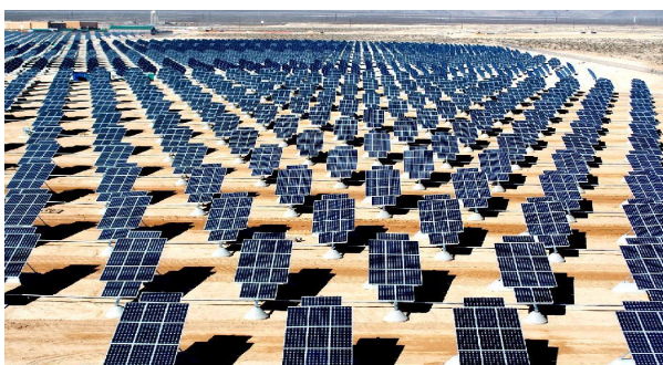
2 – расм. Қуёш электростанцияси.
