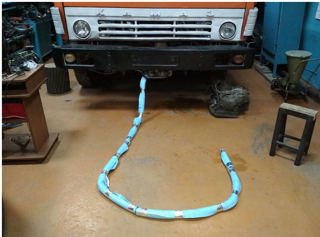
Рис. 2. Гибкий металлорукав подогревателя с теплоизоляционным материалом
